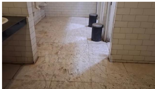
Gambar 7. Kondisi Lantai Toilet di Taman Langsung
